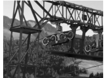
Rollenbatterie auf Stütze
